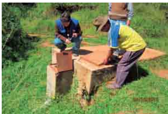
Proyecto "Construcción de Sistema de riego por aspersión", comunidad de Llinqui, Apurímac. Visitado en abril de 2013.
